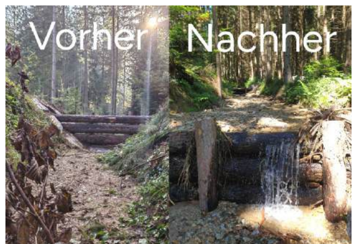
Kleinrückhaltebecken in Hochneukirchen (Credit: Cornelia Schuh)
